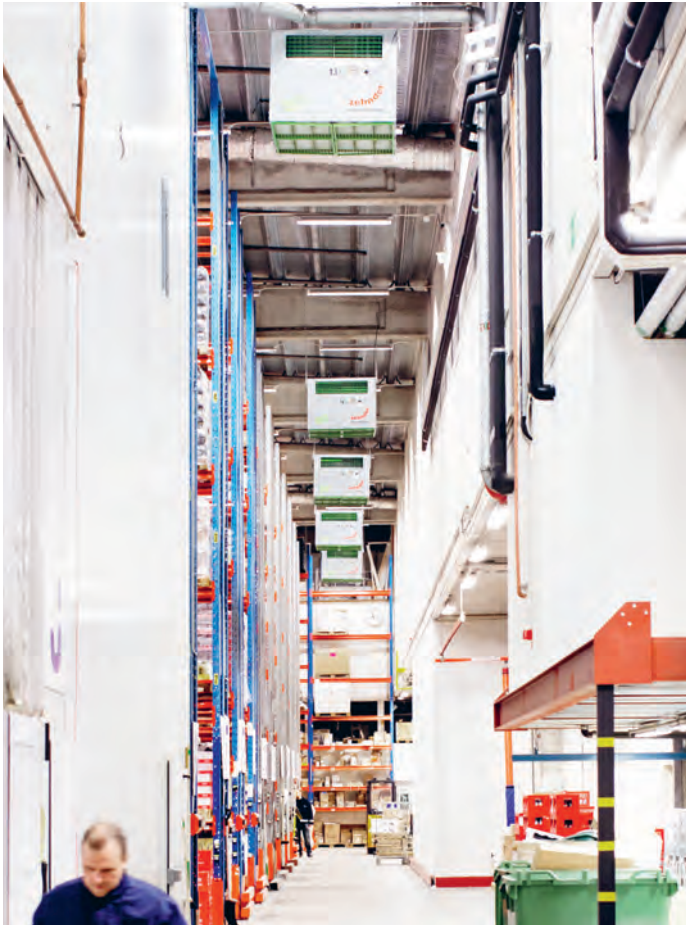
Zehnder CleanAir 12 an der Decke der Lagerhalle
